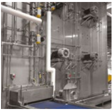
External fan motors
